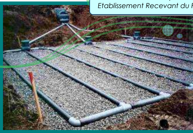
Filtre à sable adapté à un Etablissement Recevant du Public
